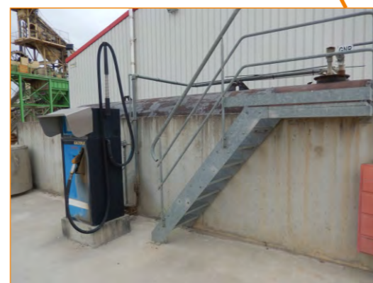
Aire étanche et station-service
